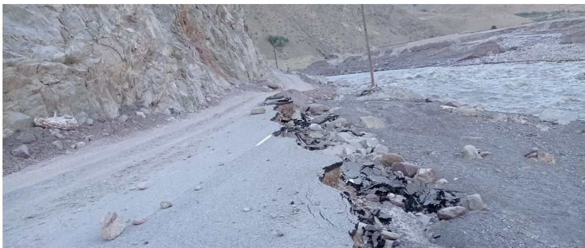
Рис. 22. Разрушенная международная дорога в Ляхшской зоне
