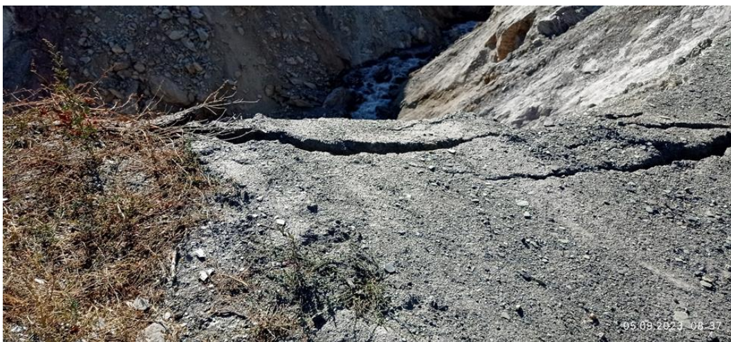
Рис. 26. Разрушенная внутрихозяйственная дорога, далее обрыв
