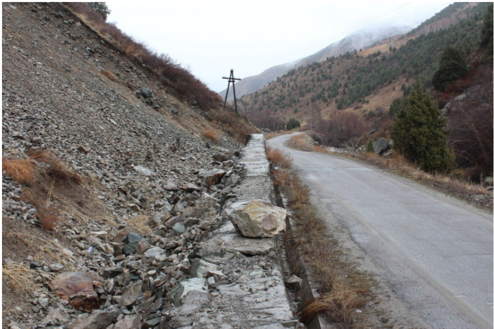
Рис.10. Участок камнепадов на 23 (36) км. Крупные камни (объемом несколько десятков дм. 3 ) при падении разбивают защитную стенку и вылетают на автодорогу, угрожая проезжающему транспорту
